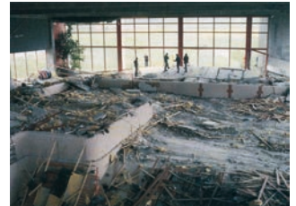
En 1985, en Uster, Suiza, cedió el falso techo de cemento de una piscina cubierta. Las suspensiones del techo de acero inoxidable no mostraban externamente ninguna imperfección, pero internamente la corrosión bajo tensión había causado la destrucción parcial del mismo.
